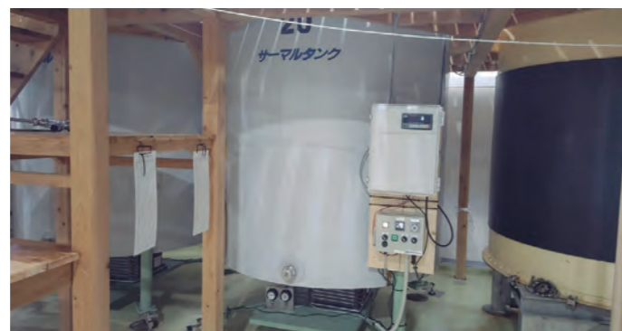
写真①：自動分析発酵タンクの右側の箱に収納されたマイコンからタンクの温度や重量がサーバーに送られ、現場に出なくても事務所で一括した監視が実現した。また、現在では数十分に1回の計測を行っているため、1日1回の計測だった従来に比べてきめ細かい温度管理ができるようになった。
